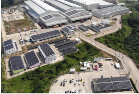
การติดตั้งโซลาร์เซลล์บนพื้นที่ โรงงานสาขาชุมพร
