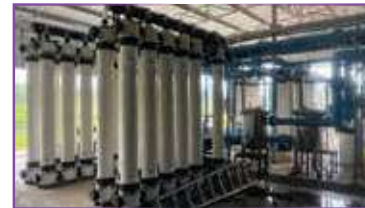
3. UF Filtration System
