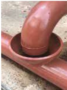
ภาพจุดเก็บน้ำ เพื่อนำกลับเข้าระบบ
