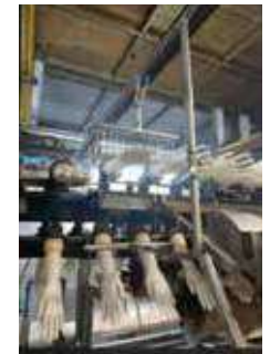
ภาพการติดตั้ง หัวกระจายน้ำร้อน ที่จุดใช้งาน
