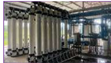
3. UF Filtration System
