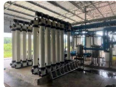
3. UF Filtration System
