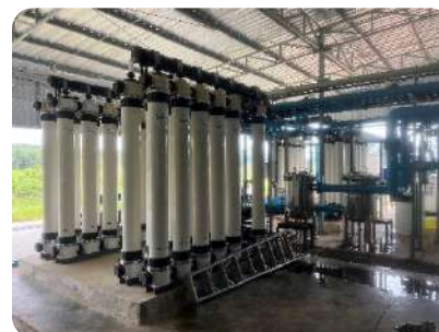
3. UF Filtration System
